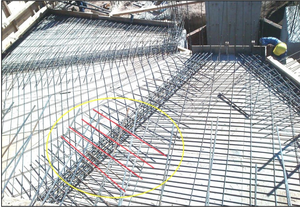
Figura 4.4.11: Imagen tomada durante el armado de la losa de la rampa en donde se observa el posicionamiento de la armadura superior de refuerzo incorrecta.
