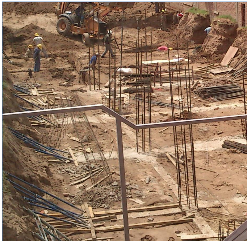
Figura 4.3.1: Fotografía tomada en el predio de la obra en donde se observa en posición la armadura de columnas.
