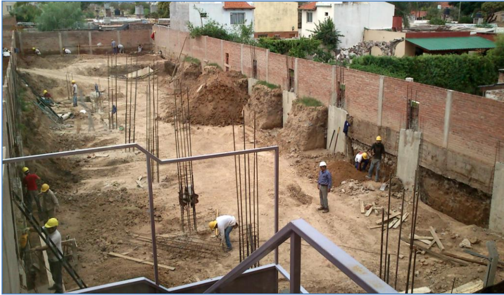
Figura 4.2.25: Fotografía tomada durante la excavación de los taludes para la ejecución de los tabiques de submuración.
