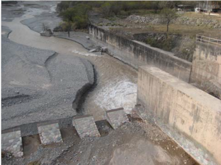
Figura 5: Erosión local al pie de las estructuras de descarga.
