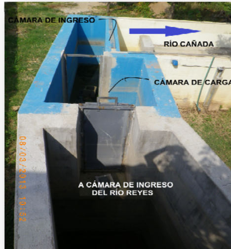
Figura 11: Cámara de carga del río Reyes.
