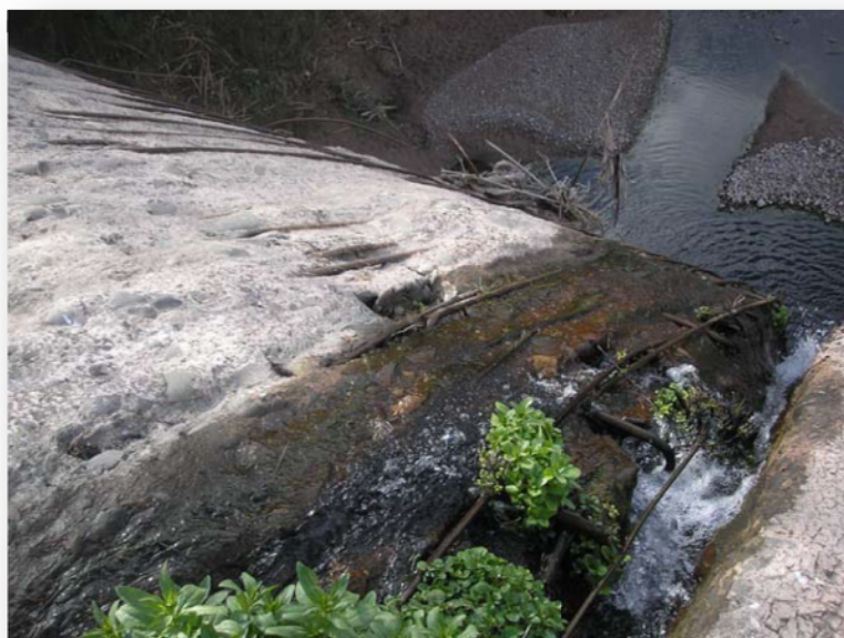
Figura 6: Erosión en el perfil del vertedero del Dique Fijo (DF)
