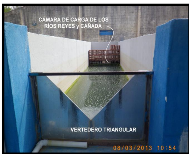
Figura 11: Cámara de aforo del Río Reyes
