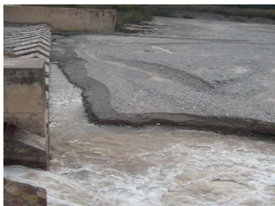
Figura 8: Erosión localizada al pie del canal moderador
