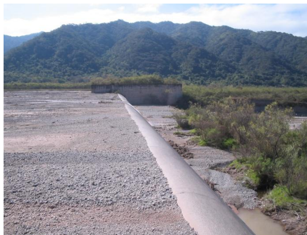
Figura 4: Tarquinamiento del dique fijo
