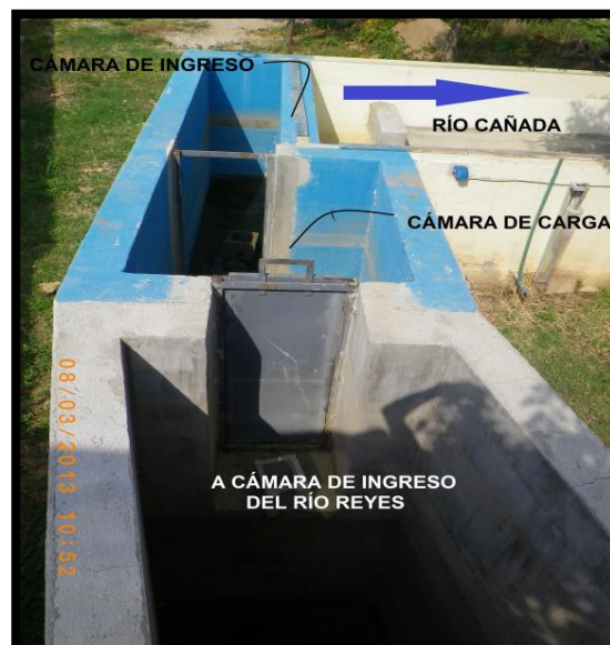
Figura 12: Cámara de carga del Río Reyes
