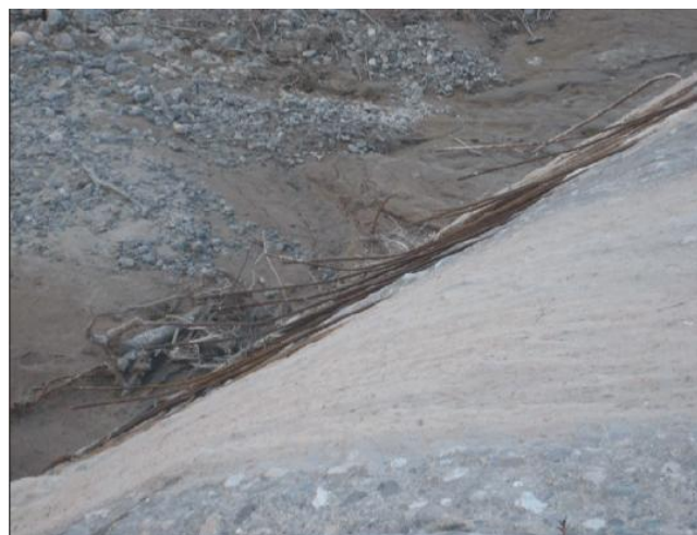
Figura 7: Abrasión del dique fijo
