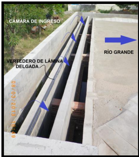
Figura 14: Cámara de ingreso Río Grande
