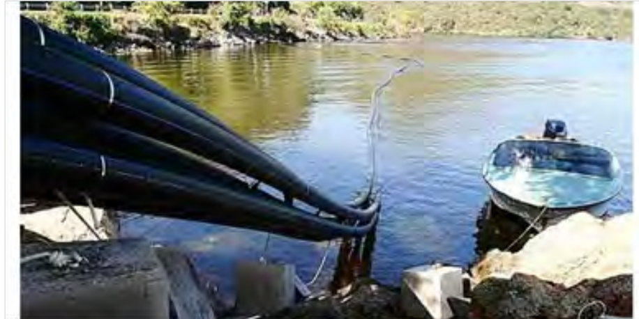
Figura 3.2: Foto tomada en 2008 por la Subsecretaría de Recursos Hídricos de la provincia de Córdoba durante la instalación de los difusores.
