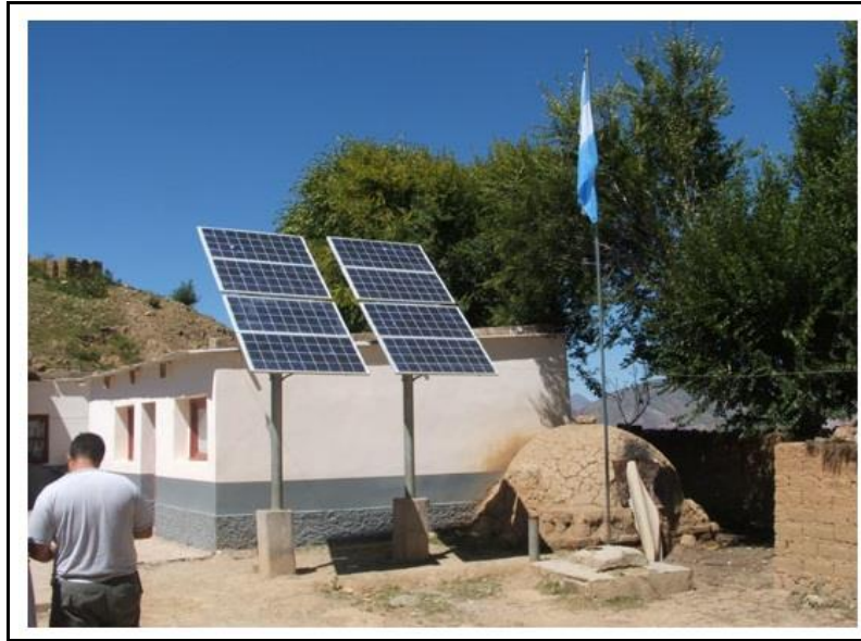
Figura 22. Proyecto de Paneles solares e instalaciones internas en Escuela Rural en Jujuy, Febrero 2010 ( www.permerjujuy.gov.ar )
