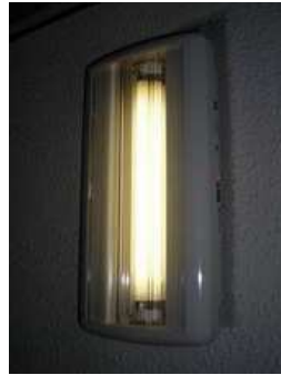
Imagen 4.5.- iluminación de emergencia
