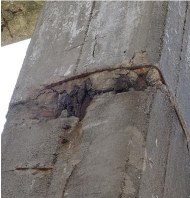
Figura 8. Corrosión de armaduras principales con pérdida de sección resistente
