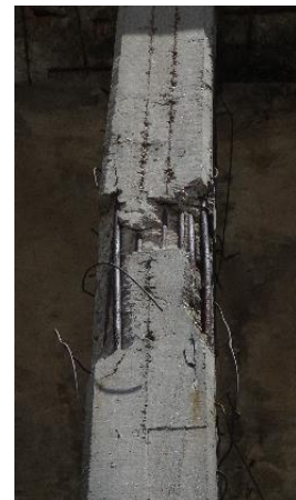
Figura 18. Reventones de recubrimiento y progreso de las fisuras verticales.
