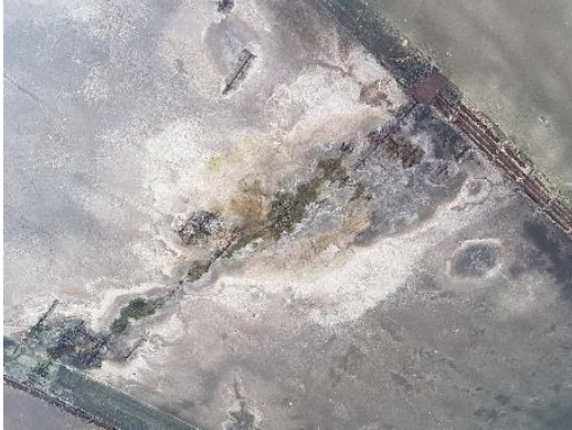
Figura 14. Grietas, armaduras expuestas corroídas, filtraciones de agua y manchas en la cara inferior de las losas.
