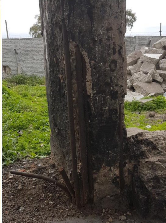
Figura 11. Pérdida de sección de hormigón en la zona inferior de las columnas principales y armaduras intencionalmente cortadas.
