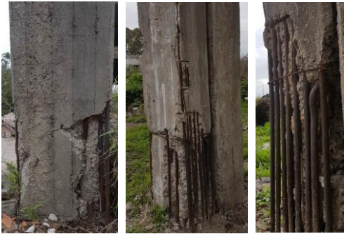
Figura 13. Pérdida de sección de hormigón en la zona inferior de las columnas principales en coincidencia con empalmes de las armaduras de las fundaciones.
