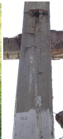
Figura 17. Fisura vertical de 1.0 m de longitud aproximadamente a mitad de altura en una columna.
