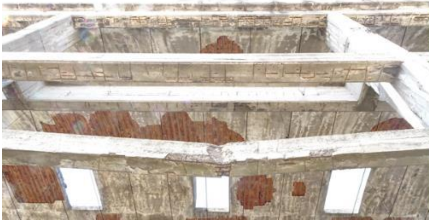
Figura 12. Vigas quebradas en fachadas norte y sur.
