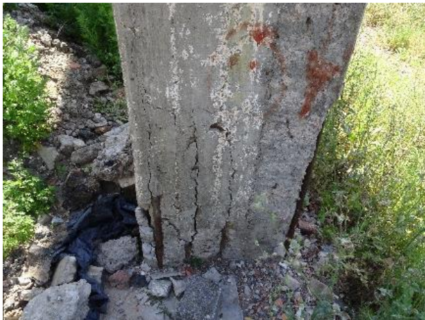
Figura 16. Fisuras verticales en la zona inferior de una columna
