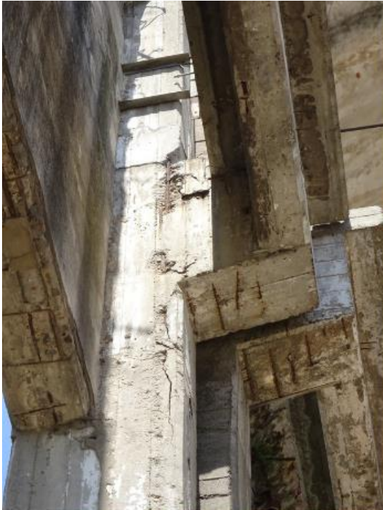
Figura 10. Desplazamiento lateral hacia afuera de las columnas del pórtico 12.
