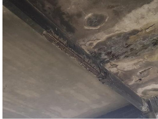
Figura 15. Armaduras con pérdida de sección resistente en la cara inferior de las vigas de entresuelo de las oficinas.
