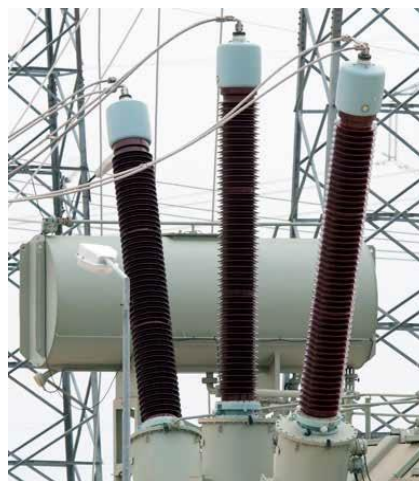
Fig. 7 AISLADORES DE UN TRANSFORMADOR
