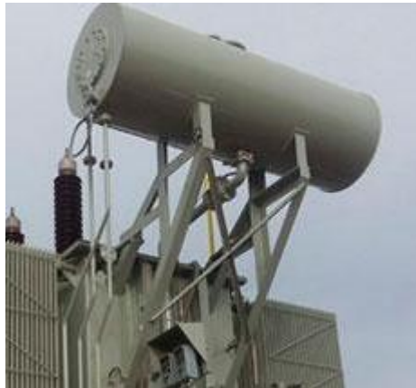
Fig. 6 TANQUE DE EXPANSIÓN DE UN TRANSFORMADOR
