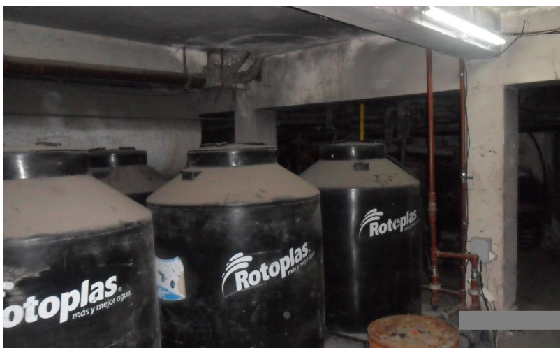
Sala de Cisternas
