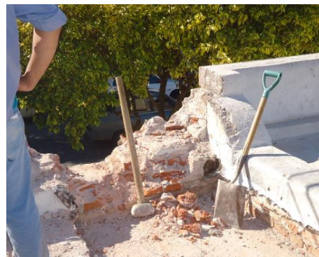
Figura 3.2.11. Ausencia de protección a linderos.
