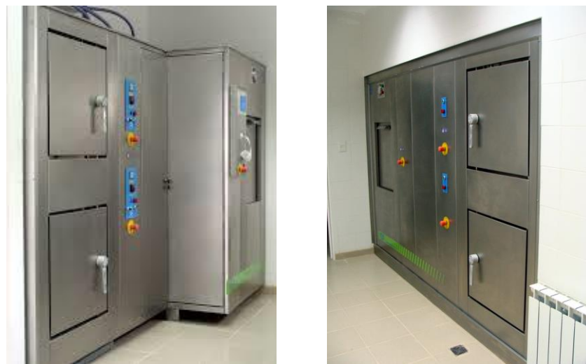
Foto 1. Equipos de óxido de etileno.
