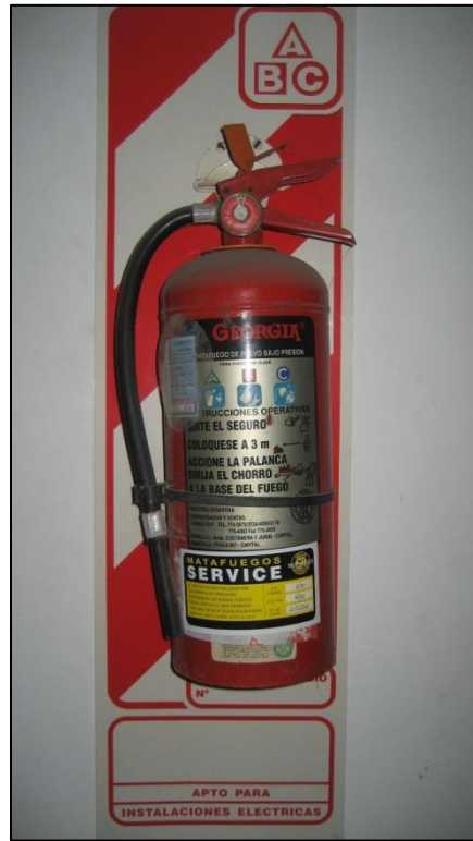
Extintor de Polvo Químico (ABC) de 5 kg
