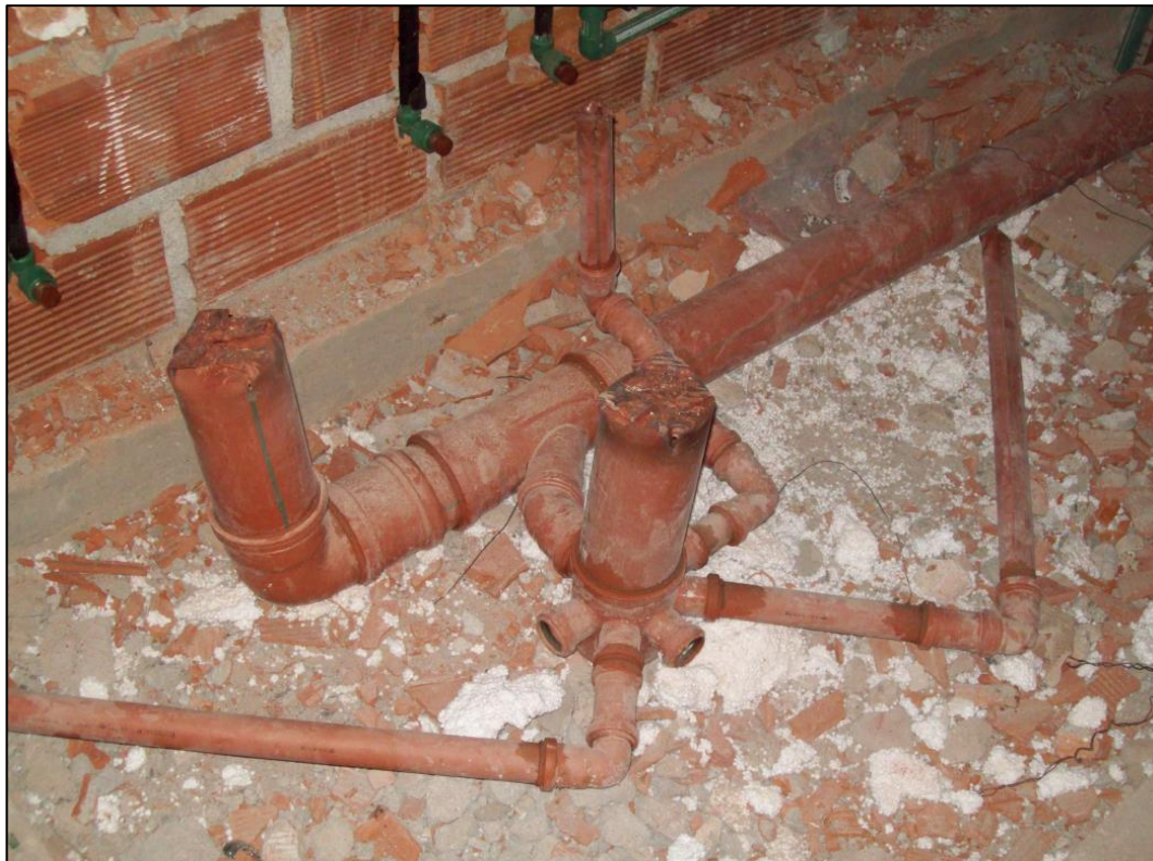
Instalación Cloacal en Baño
