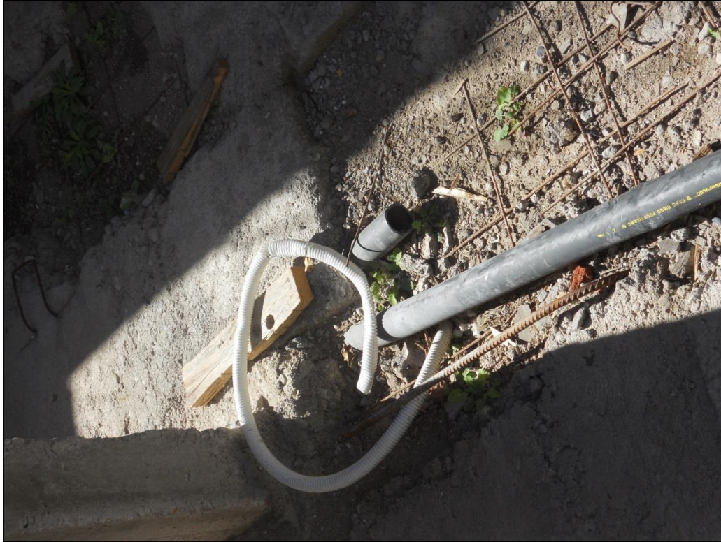
Canalizaciones para Señales Débiles
