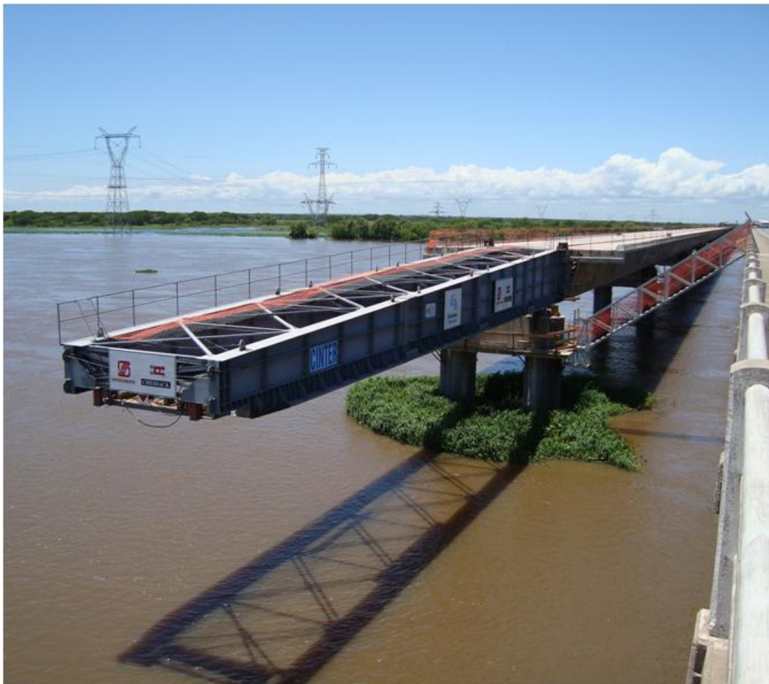
Figura N°1: Fotografía de la Viga de Lanzamiento
