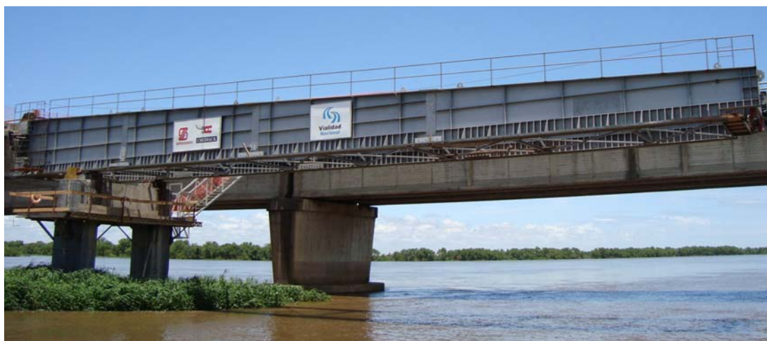
Figura N°2: Fotografía de la Viga de Lanzamiento
