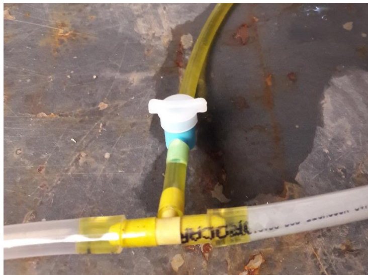
Figura 28. Unión en T para conexión de ambos sensores.
