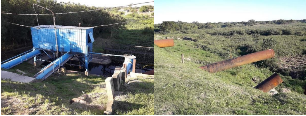
Foto N°2: Estación de bombeo con sistema de desagote llamada 9 de julio. Ciudad de Formosa.
