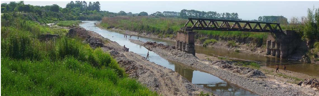
Figura 2.2. Vista hacia agua arriba del antiguo puente ferroviario, con un vano colapsado y posteriormente retirado.
